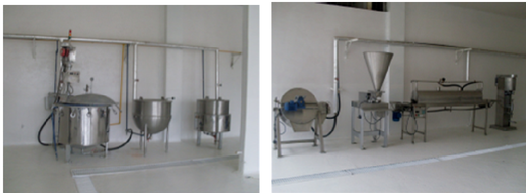
Estado actual de la planta de proceso de Coofrimayo
