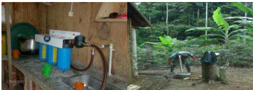
Planta de tratamiento de agua potable y abastecimiento de agua en ASOMI.
