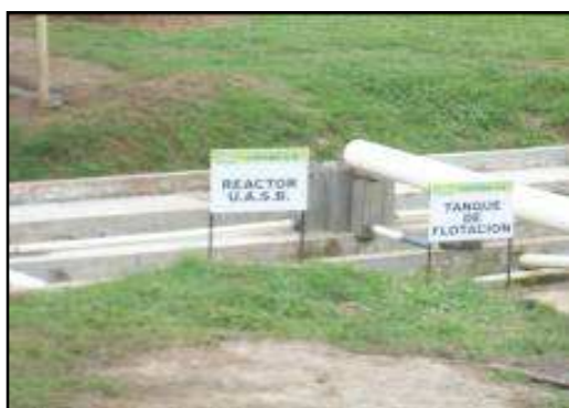
Sistema de Tratamiento de Aguas Residuales
