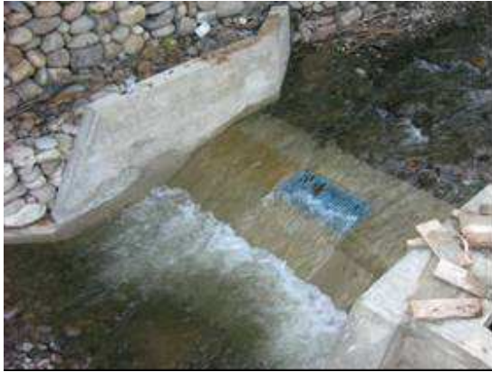
Bocatoma de fondo en concreto reforzado
