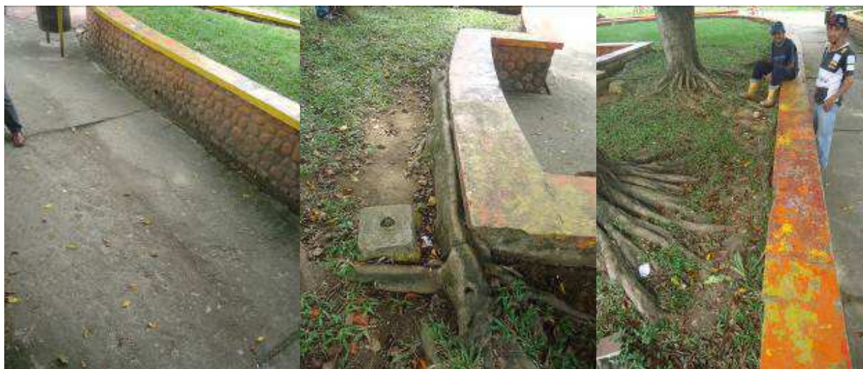
Fotos 11, 12 y 13. Agrietamiento de muros del Parque Municipal por las raíces de los árboles de la especie Ficus ( F. benjamina )
