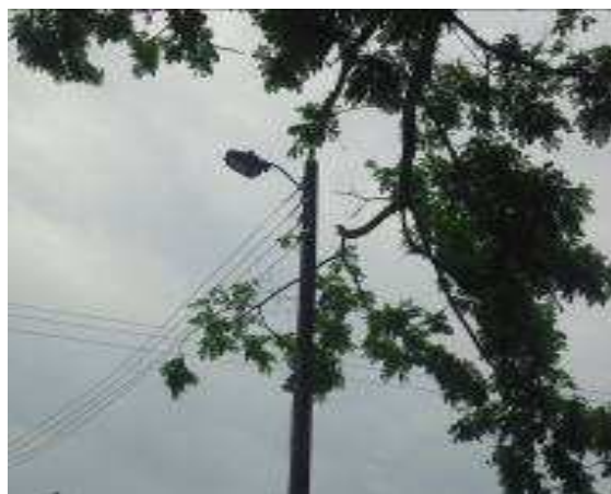
Foto 10. Ramas de la especie Samán ( S. saman ) extendidas sobre redes eléctricas
